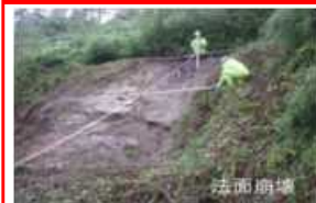
被災年月日:平成19年7月13日 通行止め:3日間
