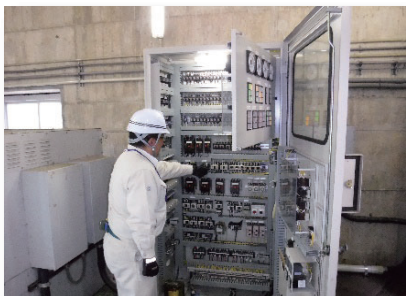
●設備点検(ゲート電力盤点検)
