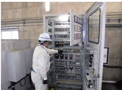
●設備点検(ゲート電力盤点検)
