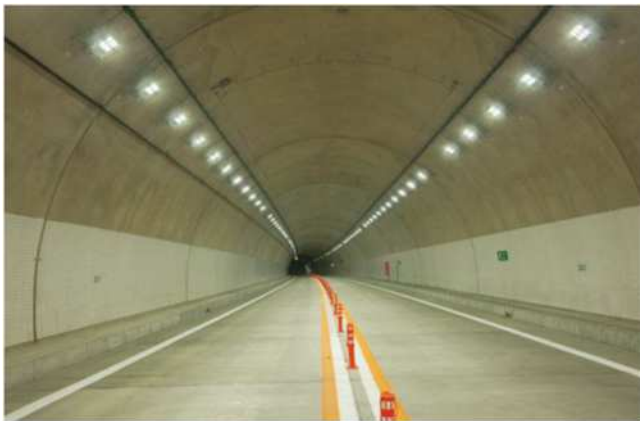
トンネル照明のLED化（資料：国土交通省）
