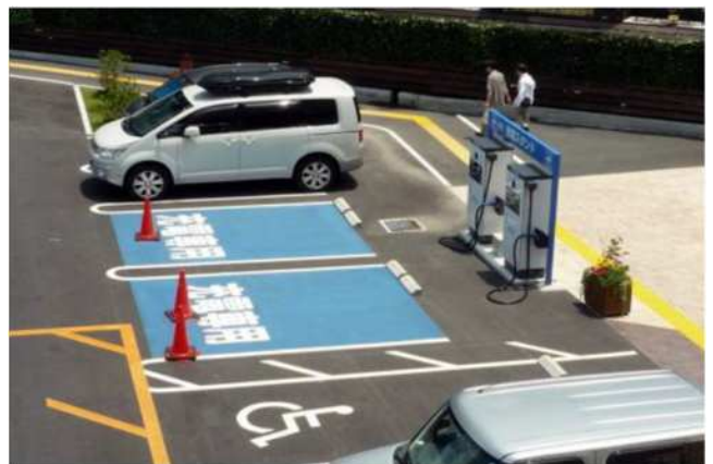
EV充電設備設置事例（資料：国土交通省）
