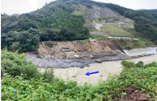
二級河川耳川被災状況 (美郷町)
