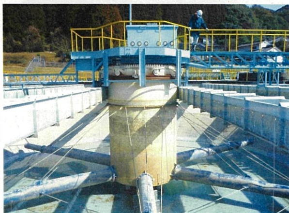
高速凝集沈殿池設備
