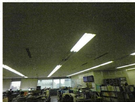
各フロアー空調・照明現況
