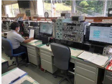
油津漁業無線局受信施設の更新
