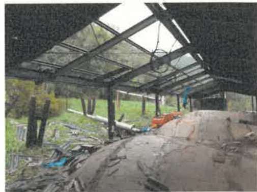
木炭窯建物屋根損傷
