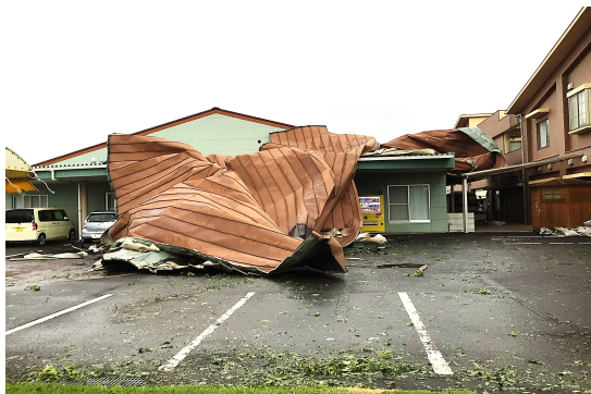
(老人福祉施設での屋根損壊)
