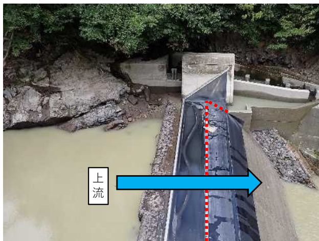
被害状況 (赤い破線の位置で破断し、めくれた状態)
