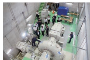
酒谷発電所(日南市)
