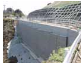
西白杵管内では、初めてE P S工法で施工された中村工区
