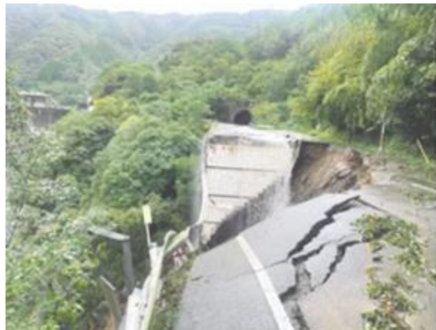
(令和4年 台風第14号による被害)
