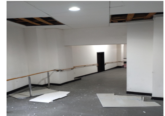
■ 県庁舎通路の被害
