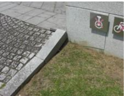
■ タイルの割れ・浮き (県立美術館)
