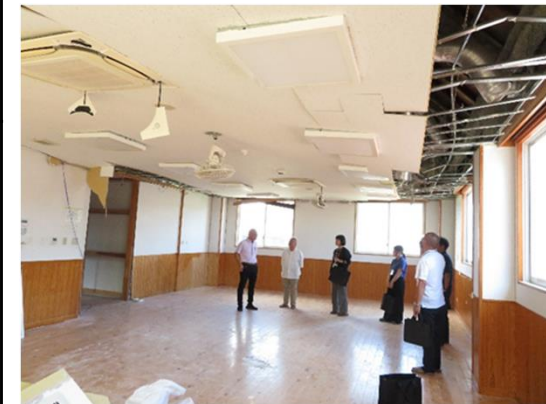
認定こども園の被害状況 (日南市)
