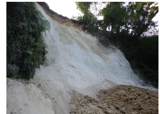
■ 山地被害の状況
