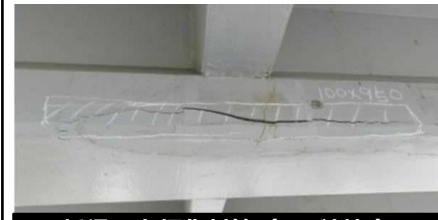
橋梁の老朽化対策（ひび割れ）
