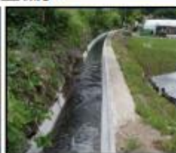
老朽化した用水路の整備・更新
