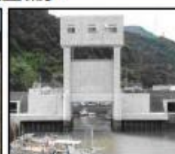
津波・高潮対策としての水門整備
