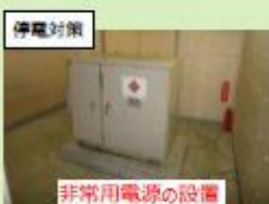
非常用電源の設置
