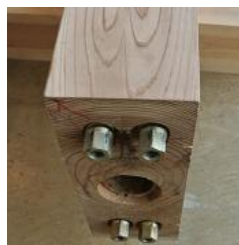
写真5 柱の割裂とLSBの引抜け破壊
