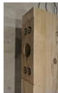
写真6 柱の中間金物によるめり込み変形
