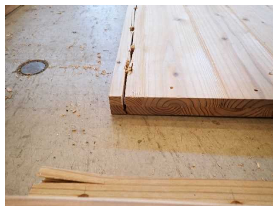
(vi) ML Tの損傷状況（左端裏側上部）
