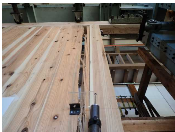
(iii) MLT割裂状況
