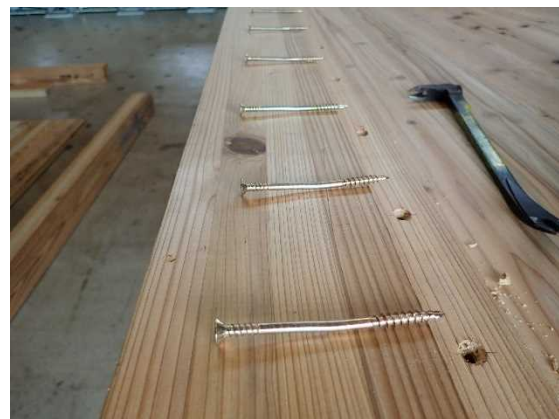
(iv) ビス (MLT－受材接合) の損傷状況
