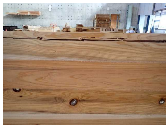
(vi) MLTの損傷状況（右端ビス部）
