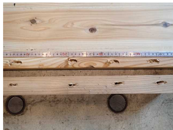
(vi) MLT 及び受材の損傷状況 (左端裏面上部)
