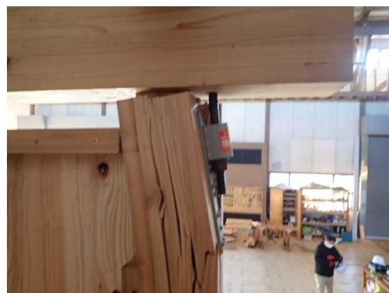
(iv) 柱（左上）の損傷状況
