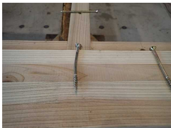
(v) ビス（MLT－受材接合）の損傷状況
