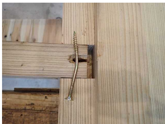
(v) ビス（MLT－受材接合）の損傷状況
