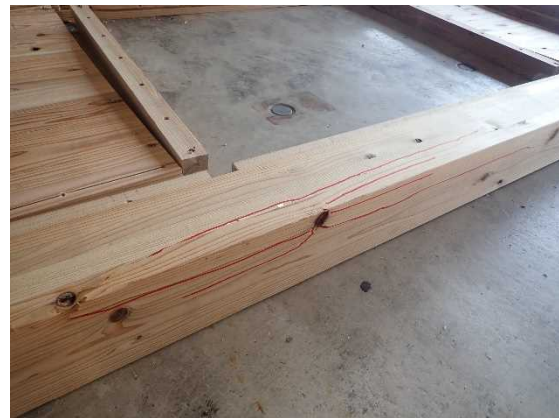
(iv) 柱の曲げ破壊（左中央部）
