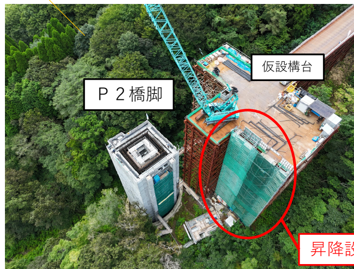
昇降設備設置状況
