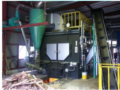
木材乾燥用の木屑焚きボイラー
