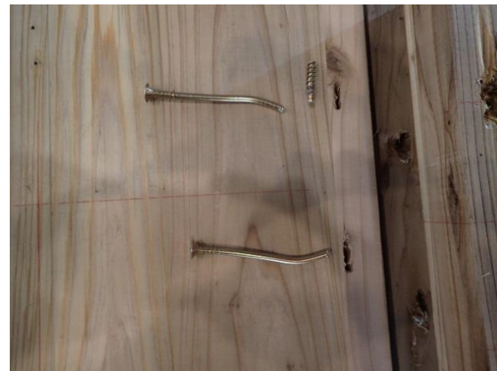
(ii) 曲げ折れたビスと CLT と柱材へのめり込み
