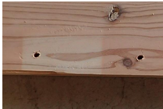
(vi) 支圧によるビス穴の微少な変形
