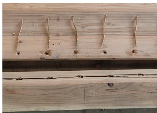
(v) ビスの曲げ変形と柱材の割裂破壊
