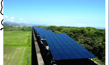
太陽光発電 (リニアモーターカー実験線跡地) 規模: 1,050kW
