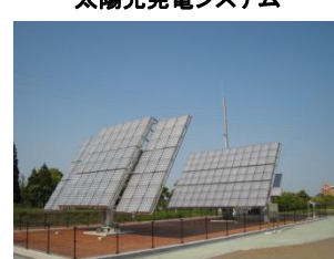
集光型太陽光発電システム 規模: 14kW × 2基(計28 kW)
