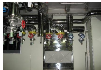
GMP空調(封じ込め)設置例
