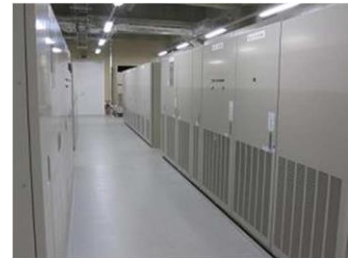
□ 無停電電源装置
